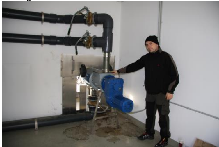
Bild 7: Fix installierter Gülleseparator. (Quelle: Hölzl)
