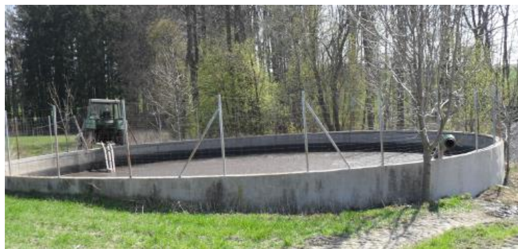
Bild 2: Künftig sollte auf die Errichtung von offenen Güllegruben und Güllelagern möglichst verzichtet werden. Die Investitionsförderung hilft, die Mehrkosten für feste Abdeckung weitgehend abzudecken. (Quelle: Hölzl)
