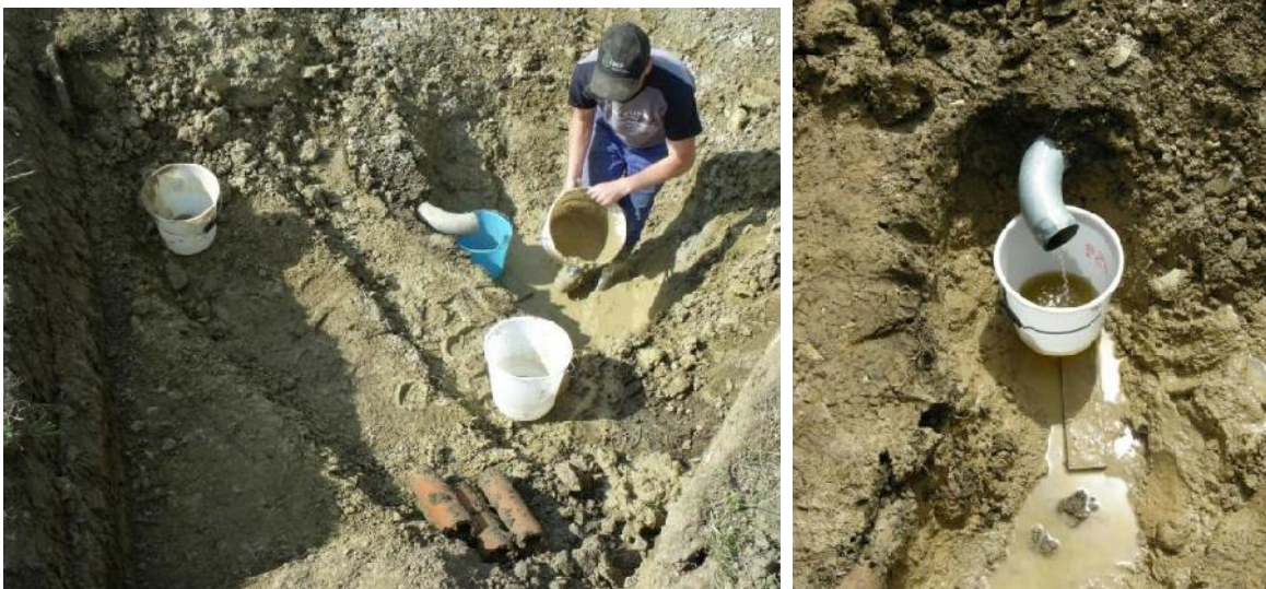
Abbildung 54 Drainage mit Ableitstutzen für Probenahme
